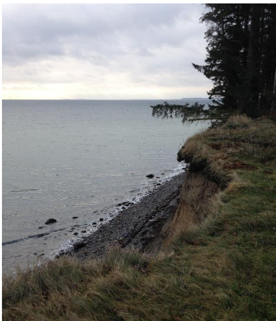
Billede 8 klint ved østlige spids på As hoved, skrænten er mellem 10 og 15 m høj. Der ses tydelige tegn på, at klinten bliver opslugt af havet med træer, der styrter i havet samt stenstrand.
