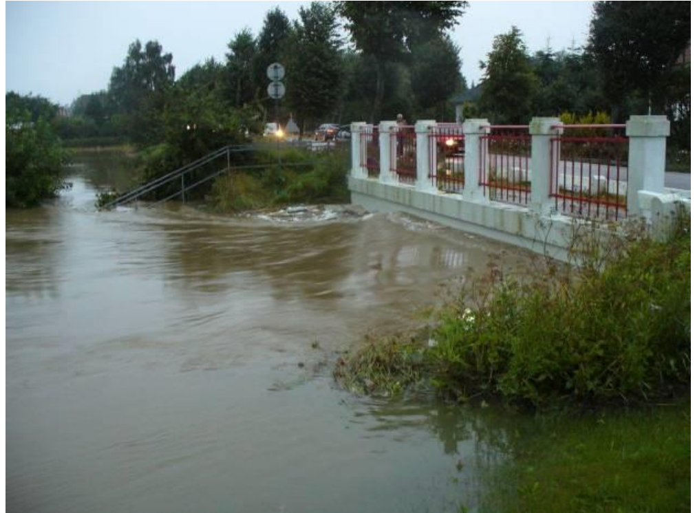
Figur 20 Oversvømmelser ved Christiansfeld 2007. Kapaciteten under broen er opbrugt og vandet stuver op på opstrøms side.
